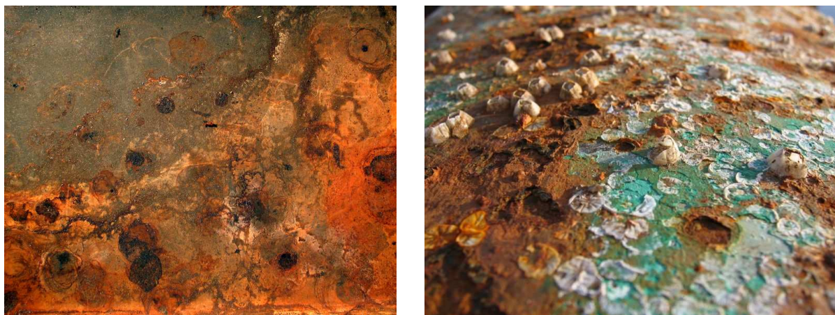
Figura 1 - Superfícies submetidas à corrosão Fonte: WIKIPEDIA
