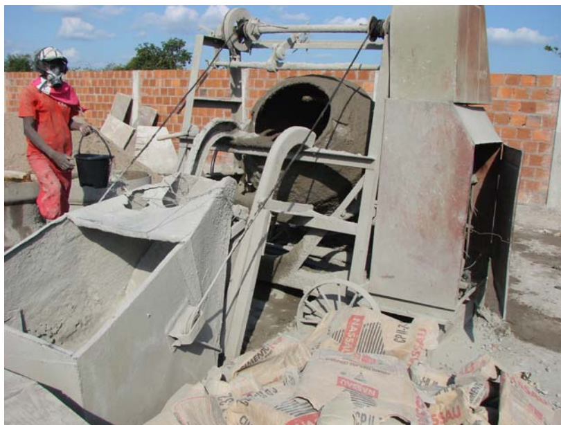
Figura 3 – Dispersão de cimento nas atividades com betoneira. Fonte: SESI
