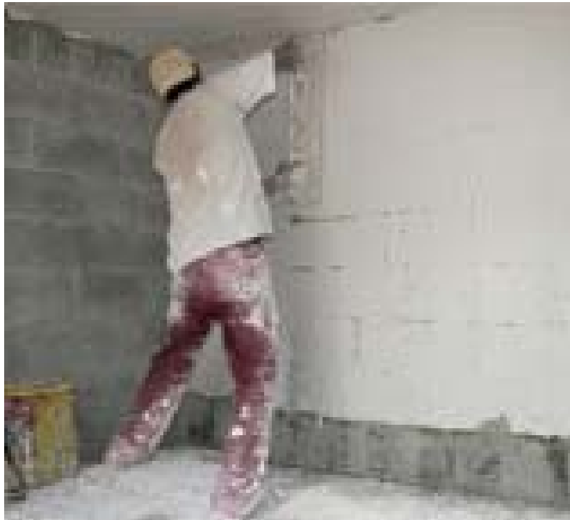
Figura 7 – Serviço de pintura de parede, deixando o trabalhador bem próximo dos agentes químicos. Fonte: Revista Técnica
