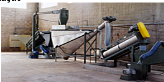
Fig. 14 Linha de revalorização de PE, PP de 300 a 1000Kg/h Disponível em: < http://www.krown.com.br/equipamentos.htm >
