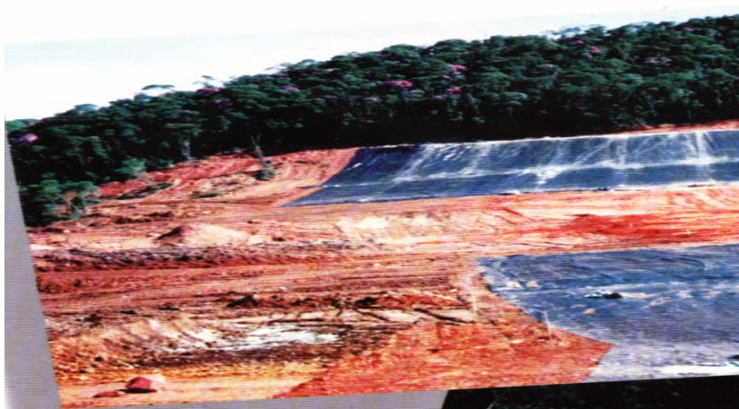
Figura 6: Terreno parcialmente impermeabilizado Fonte: ASFAMAS, 2000.
